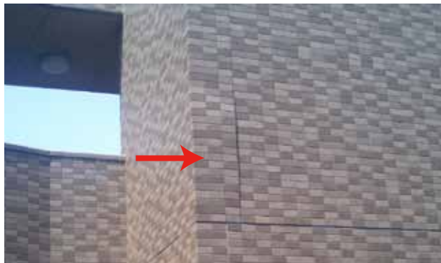
タイルが剥離している状態
